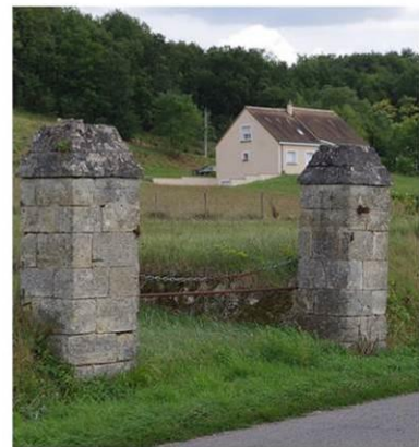
Pilastres en pierre de taille avec chaperon en façade Est de la D750. (parcelle n°387)
